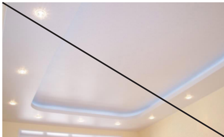
Плохо Многоуровневые гипсокартонные конструкции
